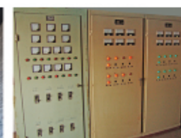
电控中心 Power control center
